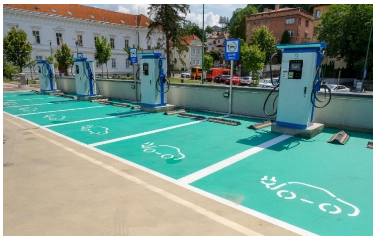
Figura 84 -Stație electrică de încărcare
